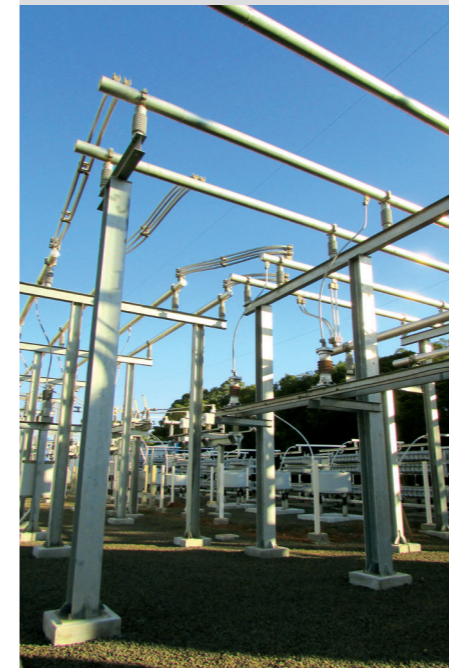
Área de ampliação da Subestação Santa Bárbara D'Oeste
